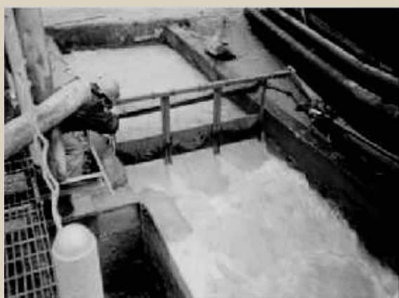
Figura 3. Drenaje ácido permanente en el Túnel Kingsmill con un caudal de 35.3 millones de m 3 /año. Río Yauli, Perú.
